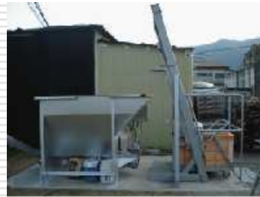
汚泥投入装置
