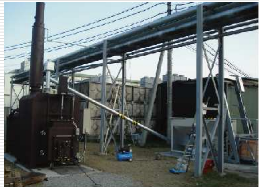
ACE汚泥燃焼処理装置
