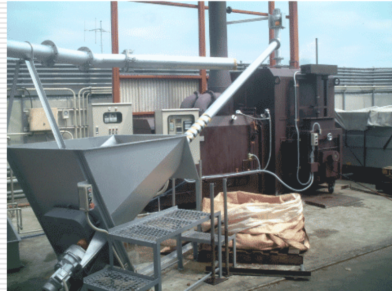
汚泥投入装置(1m 3 )と燃焼処理装置
