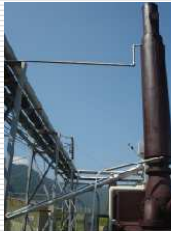
排気熱(約500℃)を熱交換し、60℃の 温水を約1.5t/h供給する
