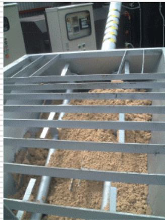
有機汚泥投入装置
