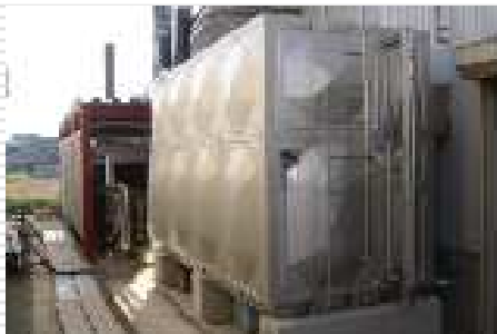
貯湯タンクと燃焼装置
